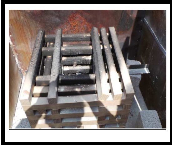
VISTA DE PRESENCIA DE FUEGO DESPUES DE LA EXPLOSION DEL SUPRESOR DE FUEGO
